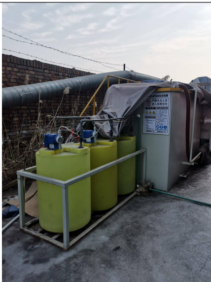
污水处理设施
