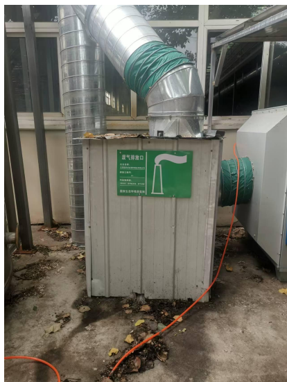
排气筒 P1 标识牌
