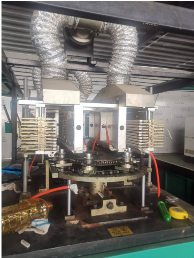
吹瓶机（拉吹机）吹塑加热工位正上方集气罩
