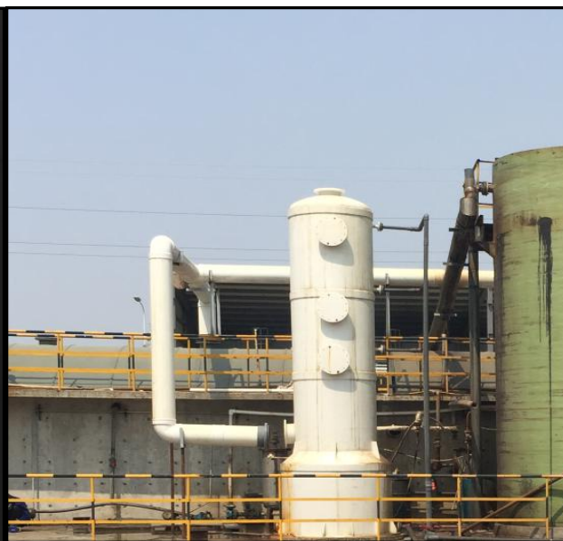
污水处理设施喷淋装置
