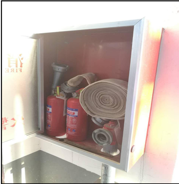
车间消防设施
